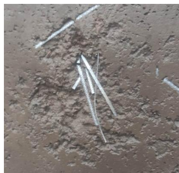
Gambar 5. Rongga pada beton
