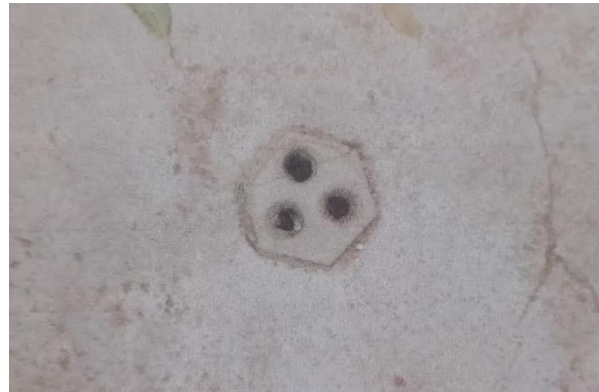
Gambar 2. Lubang Bipori di Jalanan RW 17
